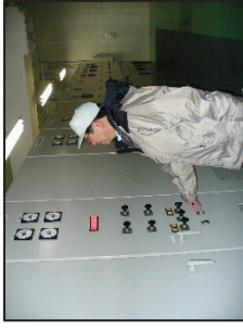
(ポンプの運転)
