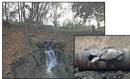
管水路における漏水事故 PC管の劣化
