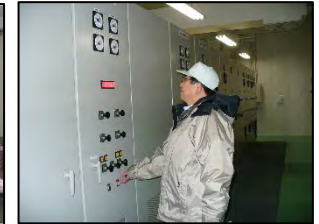
(ポンプの運転)
