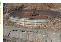
老朽化した集水井工の例
