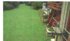
頭首工に繁茂した水草
