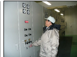
(ポンプの運転)
