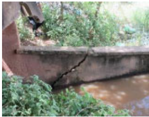
農業水利施設の劣化
