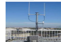
通信施設の整備
