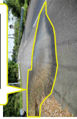
事故の兆候(漏水)
