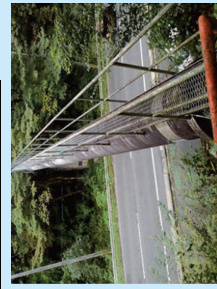
道路にある老朽化した水管橋
