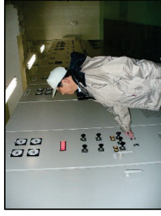
（ポンプの運転）
