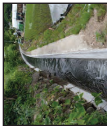
老朽化した用水路の整備・更新
