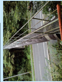
道路にある老朽化した水管橋
