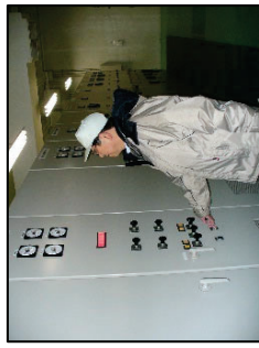
（ポンプの運転）
