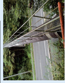
道路にある老朽化した水管橋
