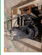
集落排水施設の更新（ポンプ）
