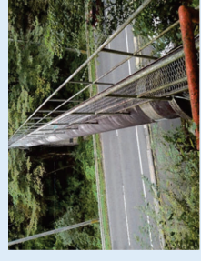
道路にある老朽化した水管橋
