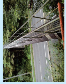
道路上にある老朽化した水管橋
