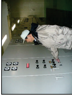
(ポンプの運転)
