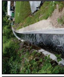
老朽化した用水路の整備・更新
