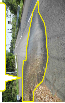
事故の兆候（しみ出し）
