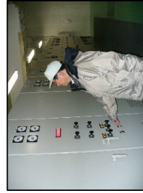
（ポンプの運転）
