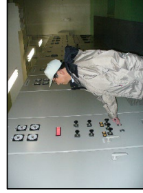
（ポンプの運転）
