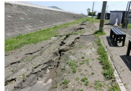
堤体の液状化
