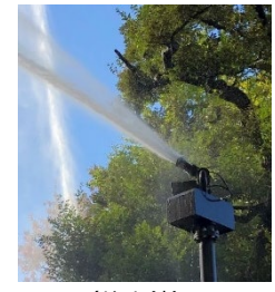
(放水銃) 近隣火災から護るための 放水銃、ドレンチャー 等
