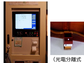
(R型受信機) (光電分離式煙感知器) 高性能な自動火災報知施設を設置し、迅速に初期消火へ
