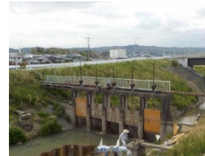
老朽化によりゲート操作ができなくなり 治水上支障がある頭首工の撤去
