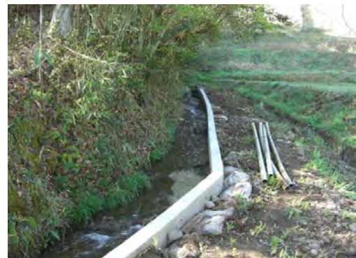
【漏水整備完成】
