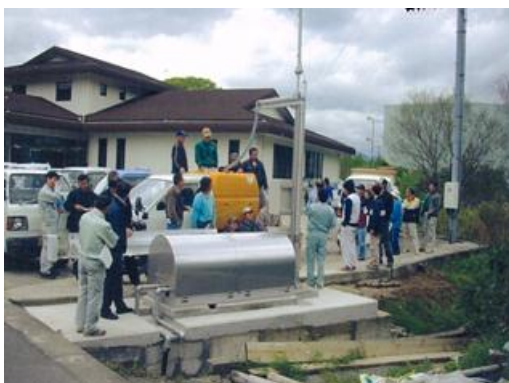
【給水施設の整備】
