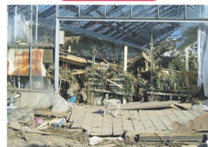
ハウスのほか、ボイラーや農機具など数千万円した機器も破壊された
