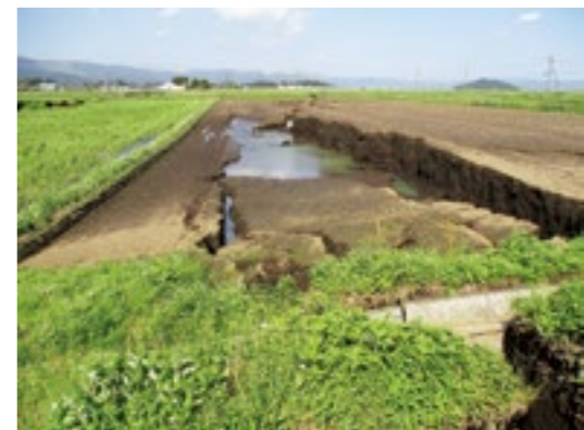
地震により陥没した水田に、雨水が溜まっている様子。
