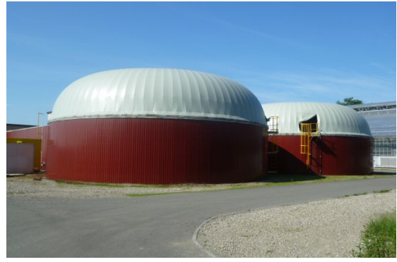
中鹿追バイオガスプラントのメタン発酵槽（円柱型）。
