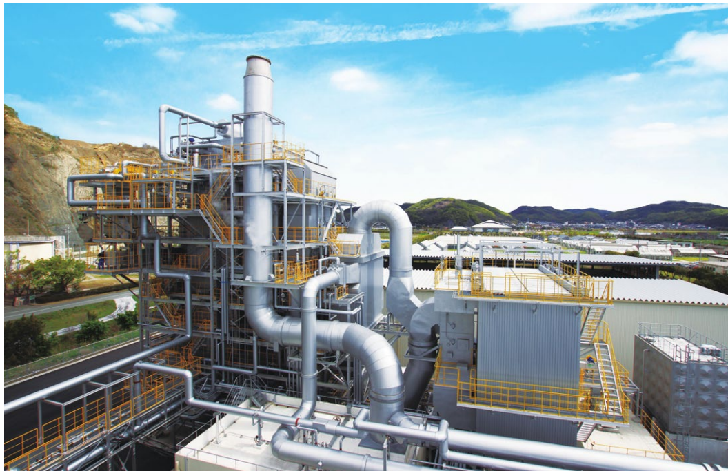
木質バイオマス発電所の様子。
