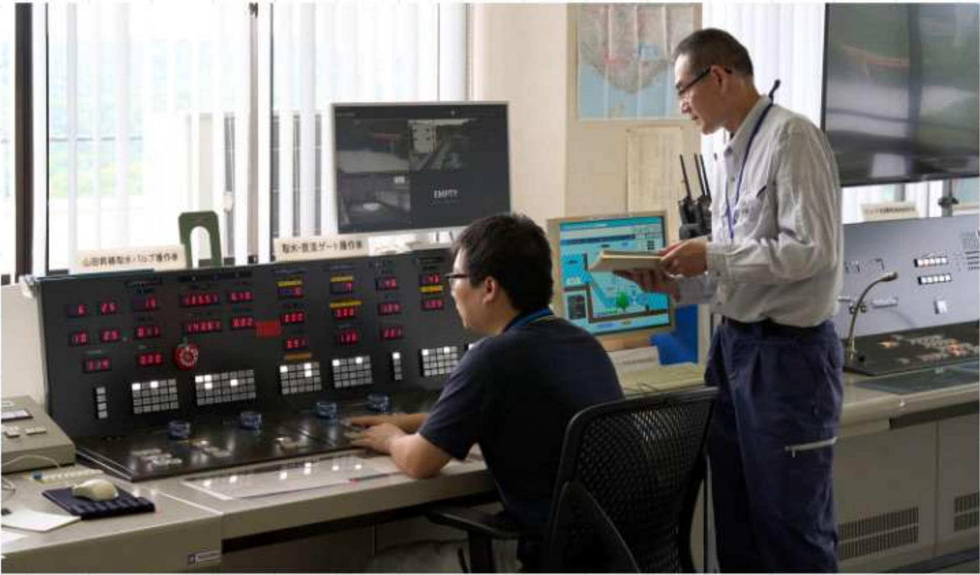
吞吐ダムにある農林水産省近畿農政局加古川水系広域農業水利施設総合管理所の水管理システム操作室。ここから3つのダムのゲートや揚水機場などを遠隔で操作・管理することができます。
