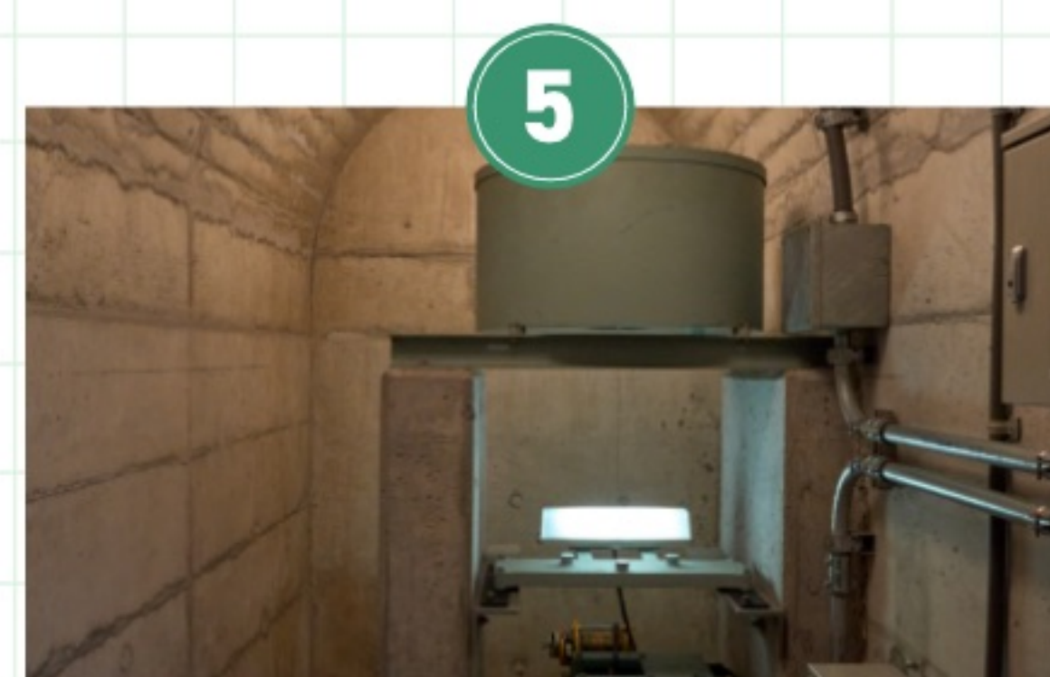
プラムライン 水圧や地盤の変形などによって生じるダム堤体のひずみを測定する計器。吞吐ダムには4カ所ある
