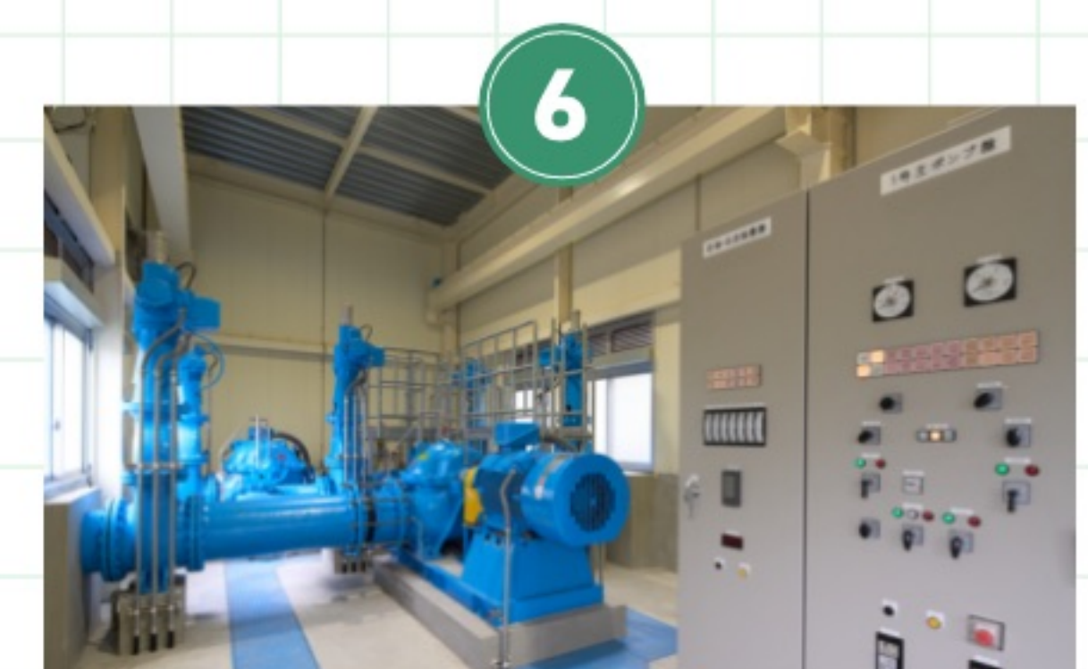
吞吐揚水機場 吞吐ダムの水を山田幹線水路に補給するためのポンプ場（東播用水二期事業で建設）
