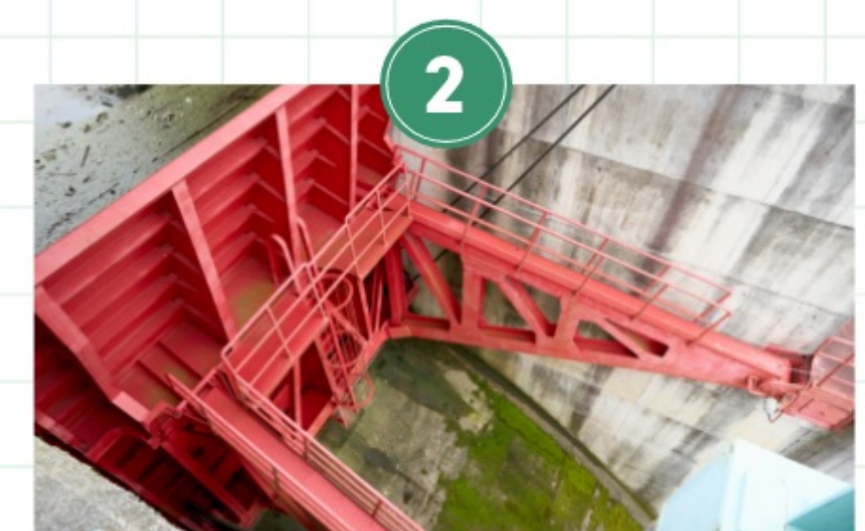
こうずいばき 洪水吐ゲート 大雨の際、最大で1秒間に925立方メートルの水を放流する能力がある
