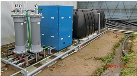
養液ろ過装置
