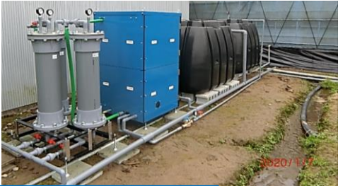
養液ろ過装置
