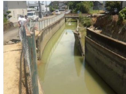
農業用水路の被害 (水路壁の損壊)
