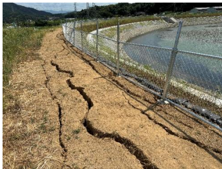
ため池の被害 (堤体上部の亀裂)
