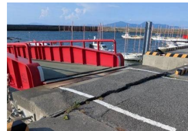
漁港の被害 (浮桟橋接続部のクラック)
