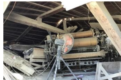
いぐさ製織作業場の倒壊
