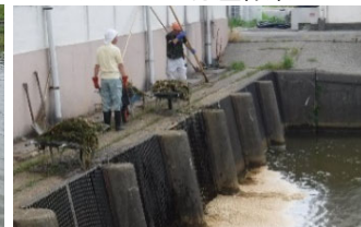
スクリーンの除塵作業
