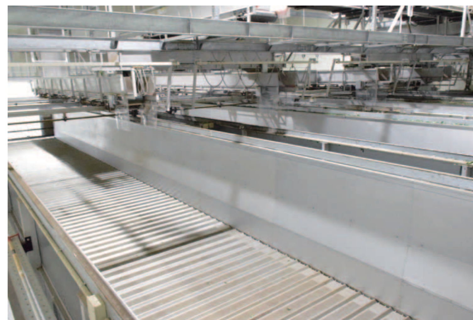
新設した碾茶工場
