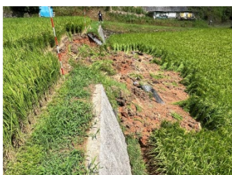
農地の法面崩壊
