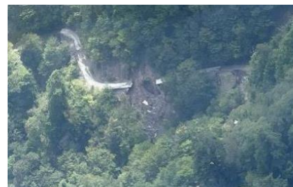
国有林の被災状況
