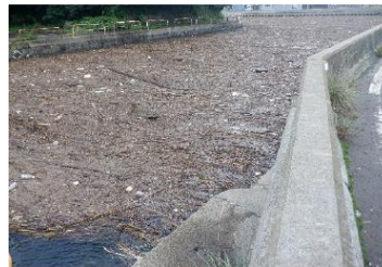
瓦礫等が堆積した漁港
