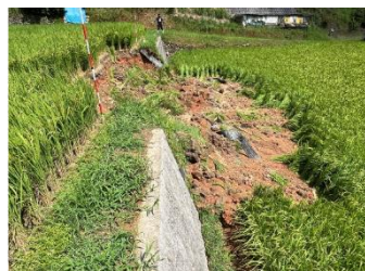
農地の法面崩壊
