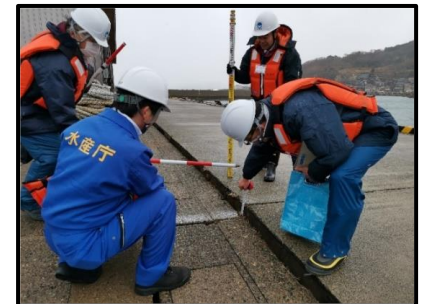
【漁港被害調査】
