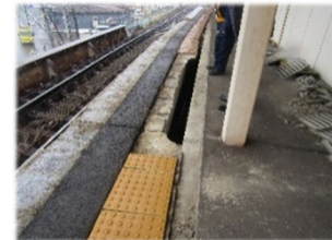
【被災した鉄道施設】
