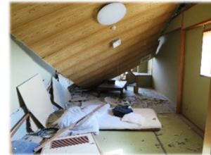
【被災した旅館客室内】
