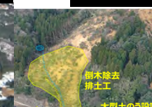
大谷地区の応急対策（輪島市）
