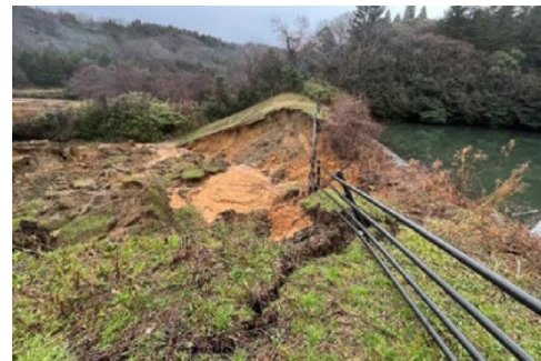
ため池の被害
