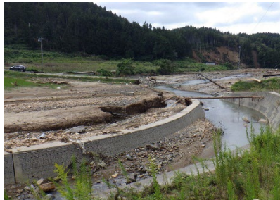
河川の氾濫による農地の被害
