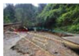
取水口の被害
