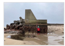
鹿磯漁港（輪島市）の地盤隆起
