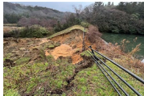
ため池の被害
