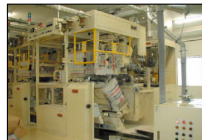
農林水産物処理加工施設 （でん粉製造施設）
