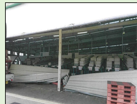
台風による農業倉庫入口シャッター損壊
