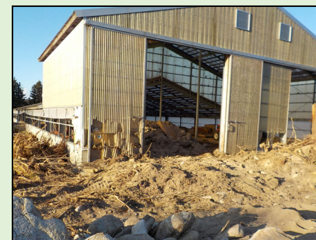
河川氾濫による土砂等堆積及び施設破損状況（堆肥施設）
