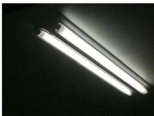
図 6-3 【リスク管理の例】蛍光灯の破損による異物混入の防止 蛍光灯カバーによる飛散防止
