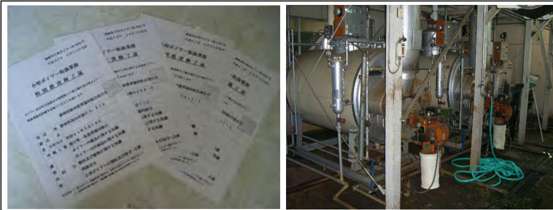
図 有資格者によるボイラー及び圧力容器の管理
