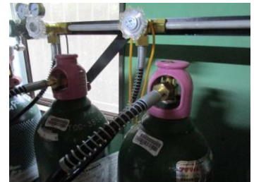
三方弁・連結ホースとポンベの接続
