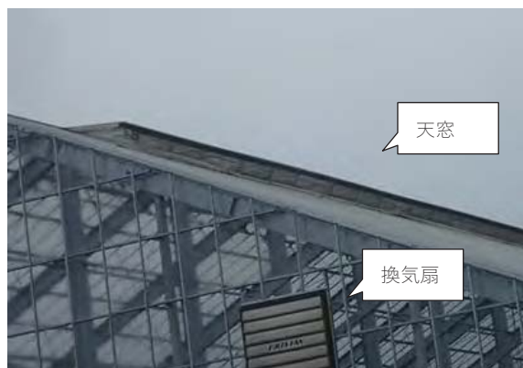
図 13 換気扇と天窓
