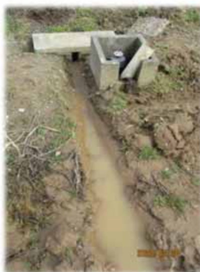
落水口が高く排水できない事例
