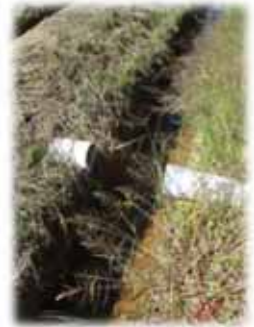
落水口の傾斜がなく排水されない
