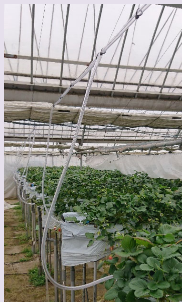
炭酸ガス局所施用の配管
